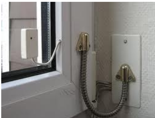
Protección puntual con detección de rotura de cristal.
